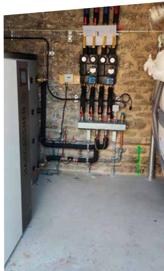
Une chaudière à granulés a été installée à la maison des associations de Plobannalec.
